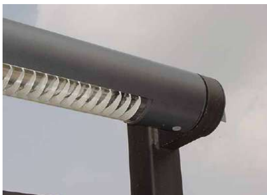
Beleuchtungsrohr an Schallwand
