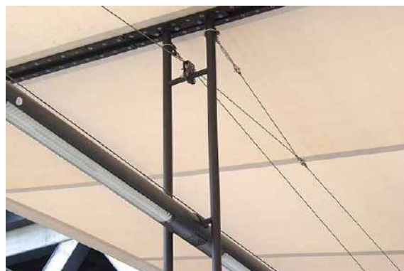
Beleuchtungsrohr am Bahnsteig
