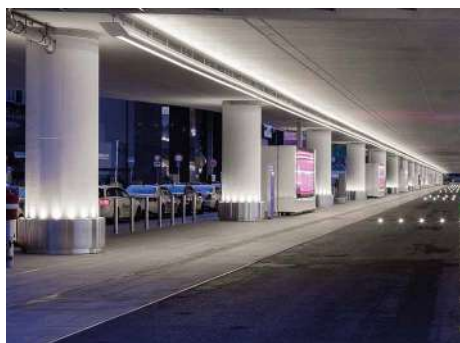
YECTO 1.R Uplights an den Stützen
