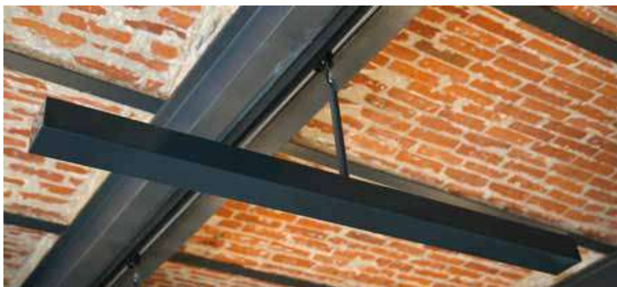
Indirektleuchte an Stromschiene
