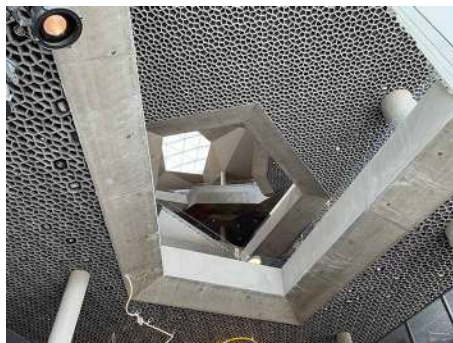
Deckenleuchten im der Wabendecke
