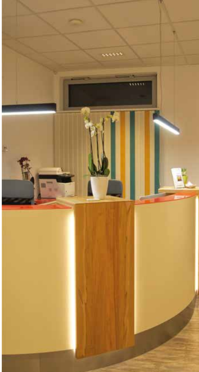
Abb.: Zwei Pendelleuchten »LYSO« leuchten den Empfangstresen mit 4000K aus. Die indirekte Beleuchtung an der Frontseite vermeidet Blendung.
